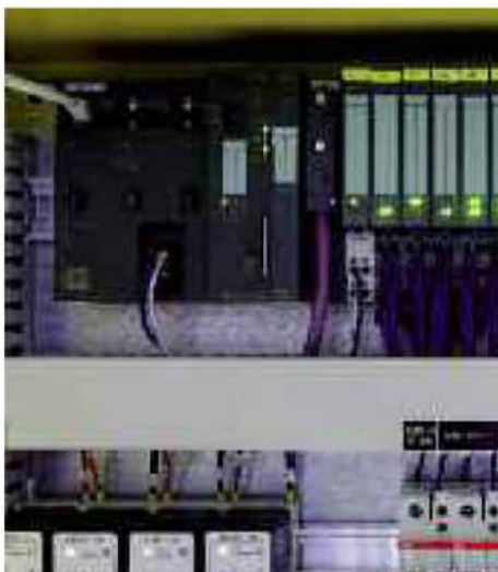
Eine Simatic ET 200S CPU IM151-8 PN/DP wird hier zur Steuerung der Klimatisierung mit Luftwäscher eines grösseren Fachgeschäftes eingesetzt.
